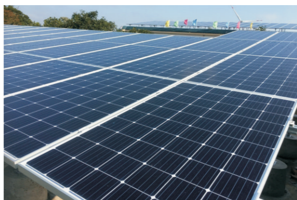
帮扶贫困村的光伏发电设备
