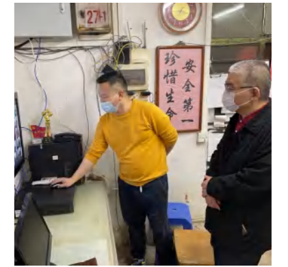
集团公司党委委员、副总经理花红林通过监控视频查看工美园区配电设备设施运行情况
